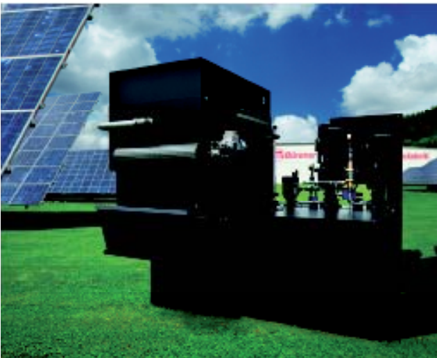
Mit Energie in die Zukunft: Moderne Kühlmittelanlage inmitten des Solarparks am Stammsitz Büren/Westfalen.
